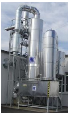
Katalytická spalovací jednotka VOC – elektrický ohřev – spalování styrénu
