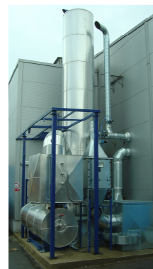
Katalytická spalovací jednotka VOC – plynový ohřev (zemní plyn)
