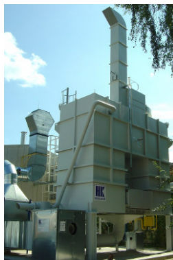
Spalovací jednotka RTO – 2 reaktory + komp. komora – ekologizace lakovny ocel. dílů
