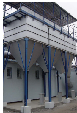
Filtrační jednotky TZL (prachových částic) z peci na tavení elektroodpadu
