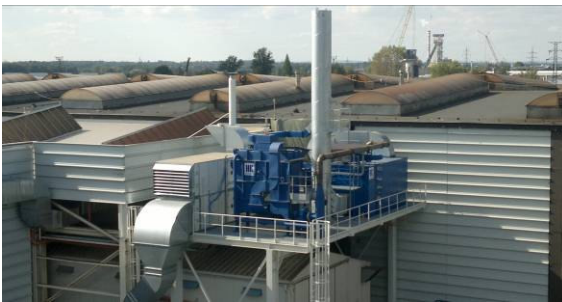
Spalovací jednotka regenerativní termické oxidace s koncentrací VOC na zeolitovém rotačním koncentrátoru – objem 40.000Nm 3 /h pro likvidaci emisí VOC z lakovny se sekční ventilací na volné ploše výrobní haly
