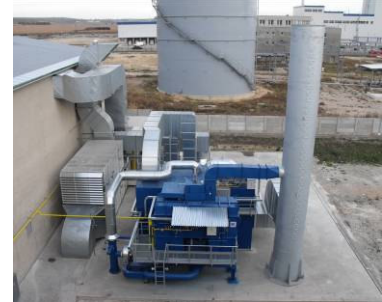
Spalovací jednotka regenerativní termické oxidace s koncentrací VOC na zeolitovém rotačním koncentrátoru – objem 75.000Nm 3 /h
