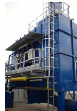
Spalovací jednotka RTO - 2 reaktory + kompenzační komora – spalování styrénu
