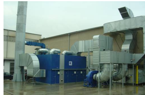
Rotační zeolitový koncentrátor VOC se spalovací jednotkou regenerativní termické oxidace (RTO) pro objem 75.000Nm 3 /hod. – povrchové úpravy ocelových konstrukcí
