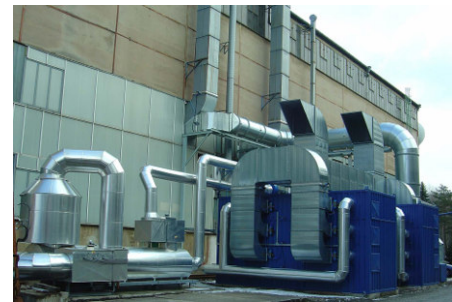
Katalytická spalovací jednotka VOC s koncentrací VOC na pevných ložích AU – rekonstrukce a ekologizace lakovny ocelových dílů – kapacita 74.000Nm 3 /hod
