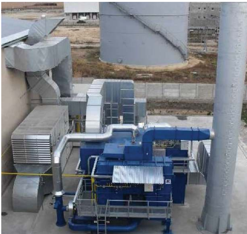
Obr. 13 - Technologie likvidace emisí VOC – celkový pohled (v popředí spalovací RTO jednotka, vlevo vzduchotechnická jednotka lakovacího prostoru) z výrobní haly lakovny ocelových konstrukcí (viz shora obr. 1 až 3)
