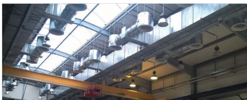
Obr. 11 - Detail stropních trysek, pod nimiž jezdí mostový jeřáb pro manipulaci s výrobky na volné lakovací ploše
